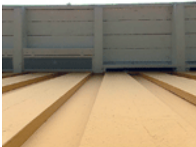
Flammen sprer seg lett gjennom luftehullene under taket.
